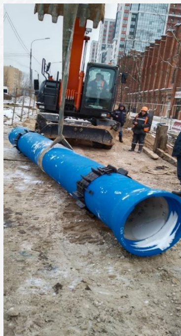
Реконструкция водопроводных сетей Д=150-600 мм с домовыми вводами Д=50-100 по адресу Железнодорожный пр. на участке от ул. Седова до тупика, от д.143 пр. Обуховской Обороны до ул. Седова
