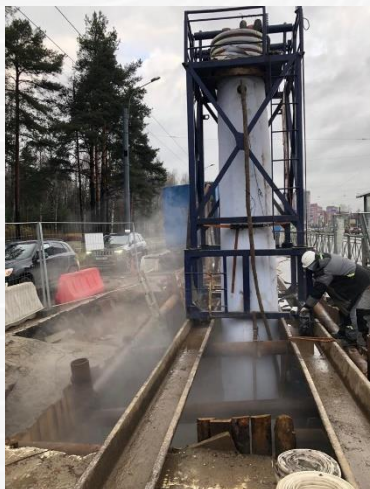
Реконструкции водопроводной магистрали Д=800-900 мм по адресу: Тихорецкий пр. от пр. Культуры до Светлановского пр.
