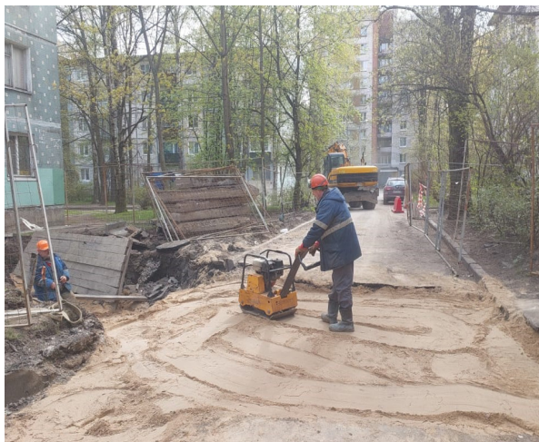
Техническое перевооружение (модернизация) тепловых сетей в квартале 17-17а Гражданки, ограниченном Северным пр., пр. Науки, ул. Карпинского, ул. Софьи Ковалевской (Ду 50-200 мм L – 2 143 м труб)
